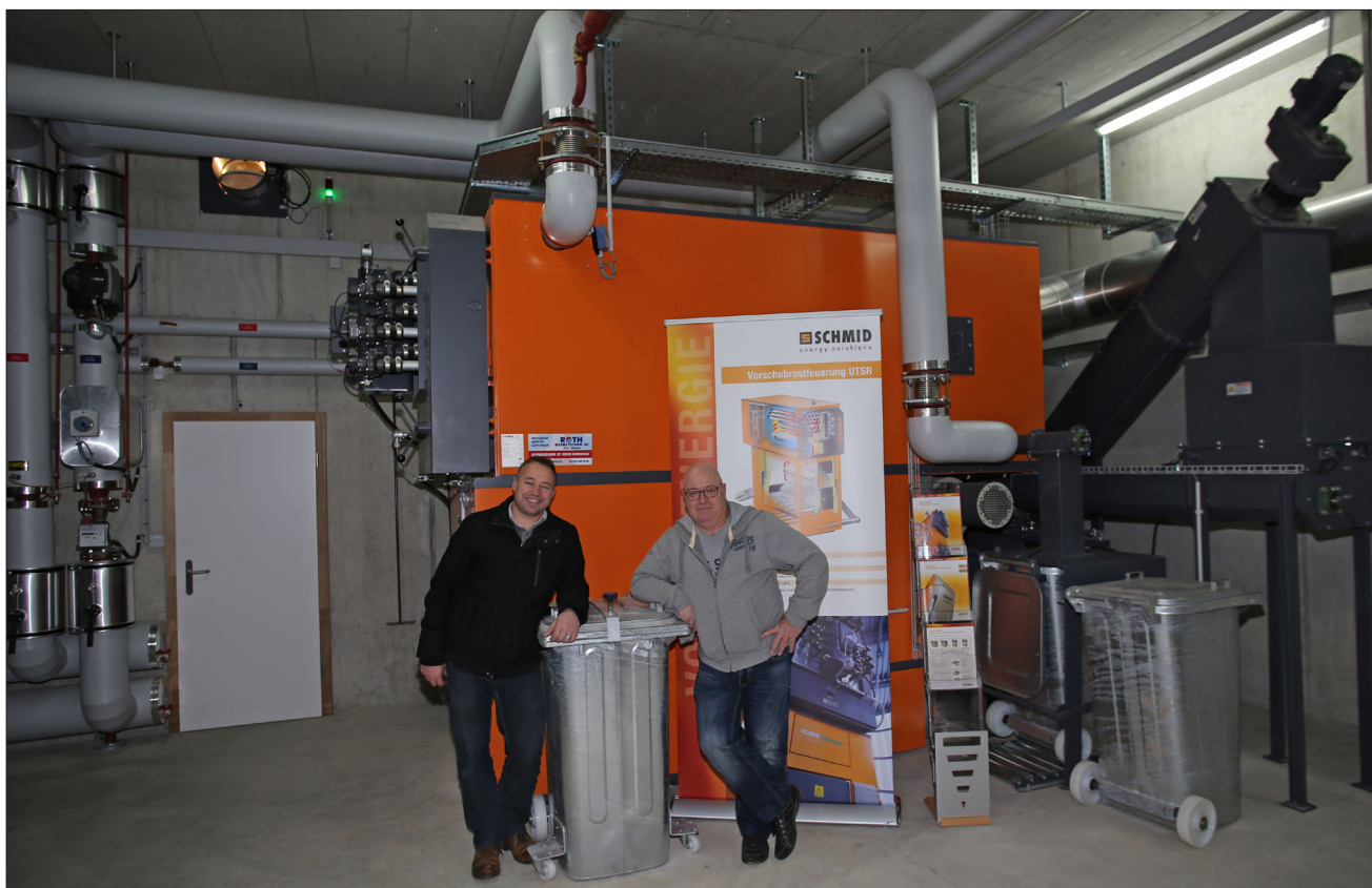
Gemeinderat Marcel Zürcher (links) und der Anlagewart Rudolf Reber in der neuen Heizzentrale.
